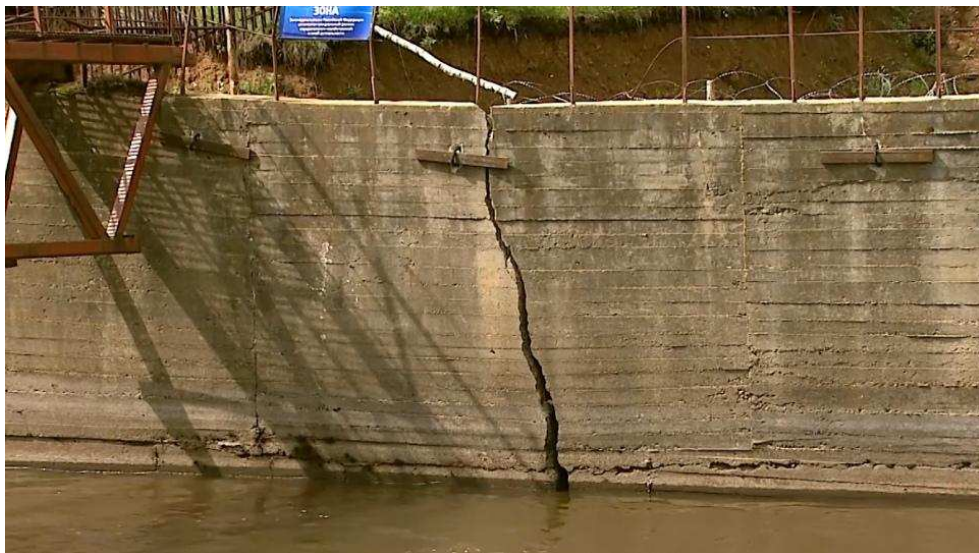
Рис. 3 Прогрессирующее разрушение монолитного железобетонного откоса ГТС Балашихинского водохранилища
